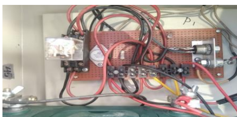
Gambar 4. Rangkaian BCR dan rangkaian penerangan yang sudah terpasang
